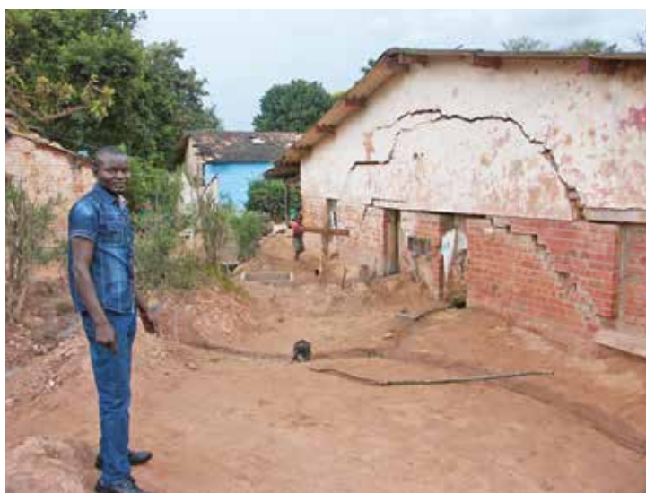
Wegen Minensprengungen haben mehrere Häuser in Musonoi gefährliche Mauerrisse erlitten.
